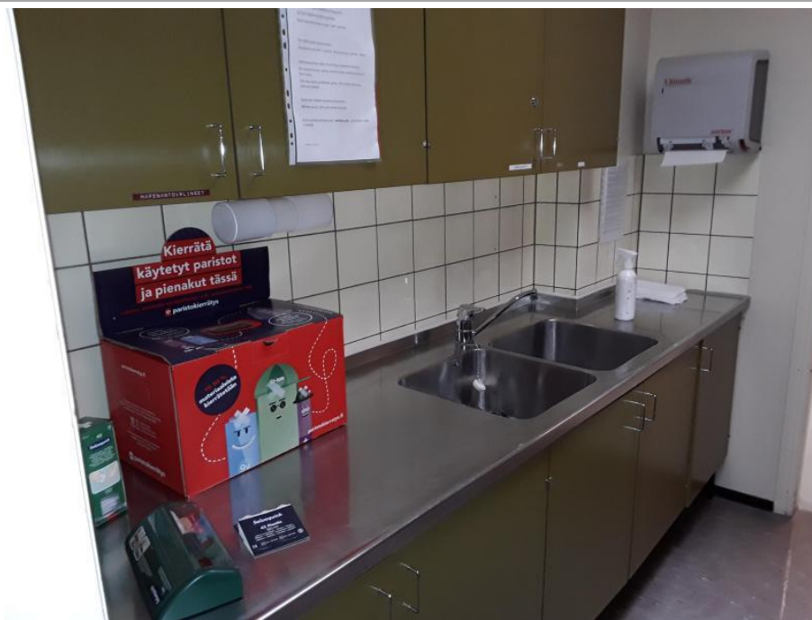
Instrumenttihuoneen 1221 välitilalaatoituksen kiinnityslaasti sisältää asbestia .
