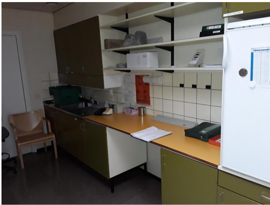
Valmisteluhuoneen 1219 välitilalaatoituksen kiinnityslaasti sisältää asbestia .
